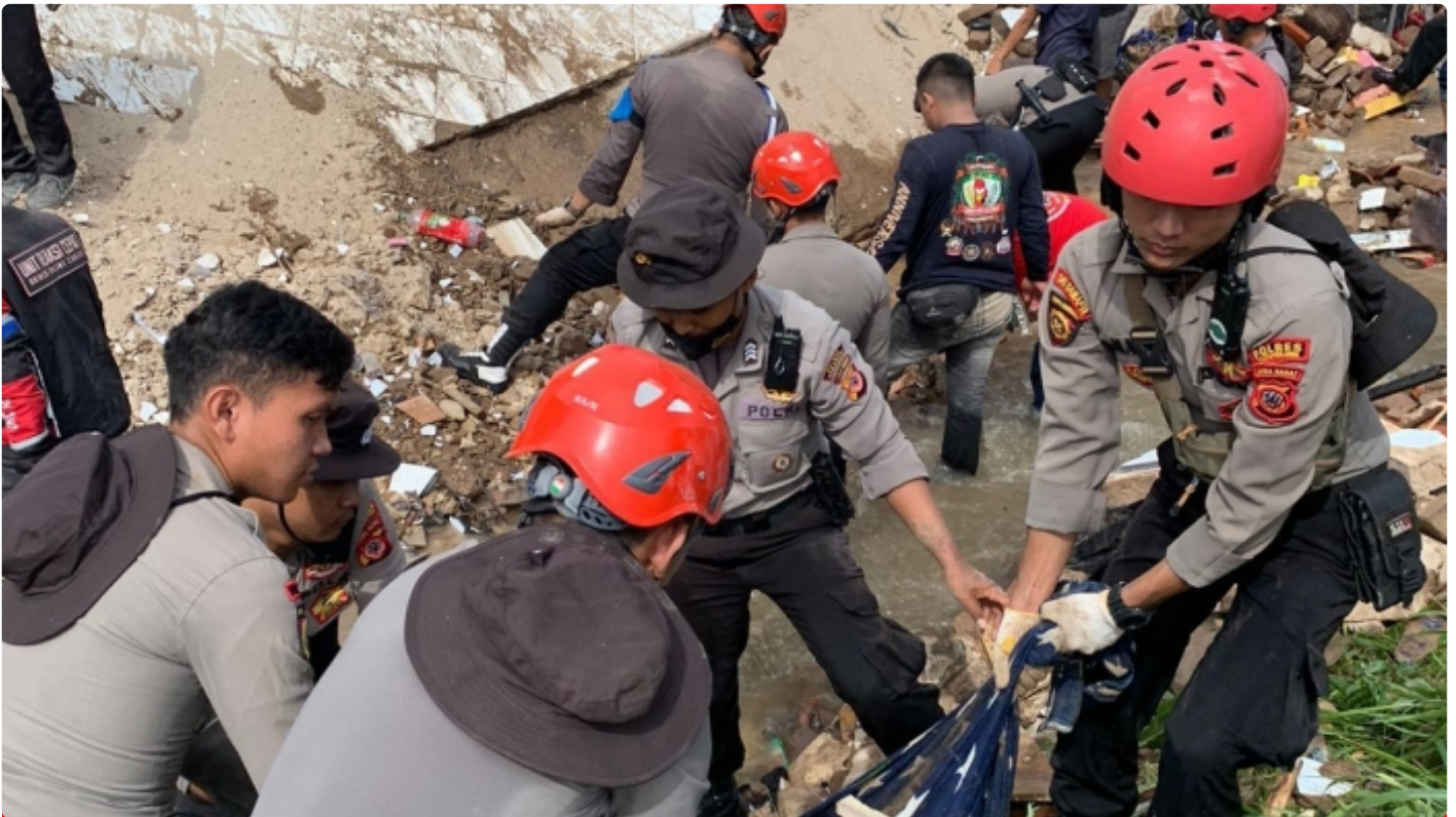
Personil Satuan Samapta Polres Sukabumi, Evakuasi Puing Reruntuhan Rumah yang Diduga Masih ada Korban Akibat Gempa Cianjur
